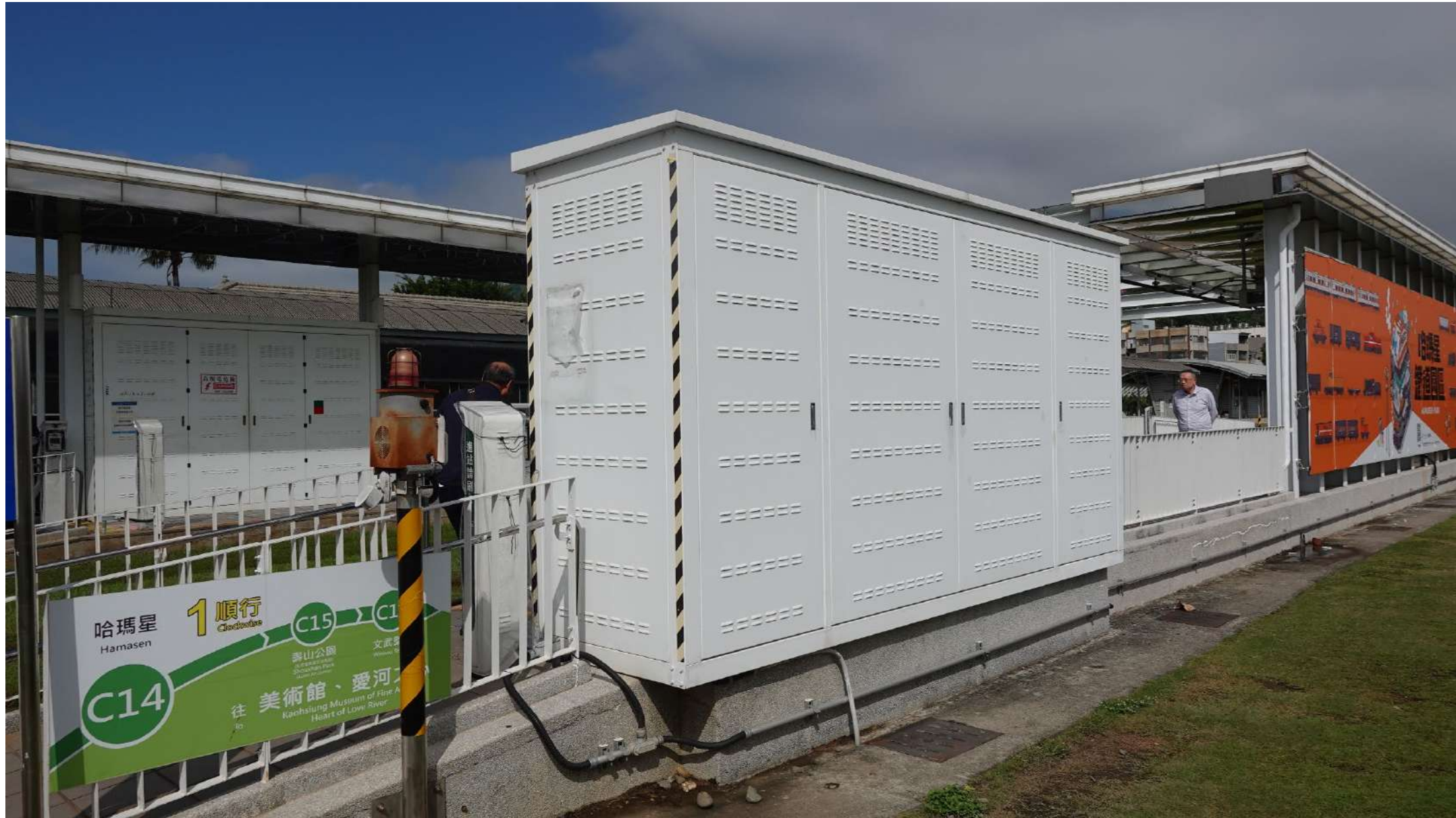
駅構内に置かれた充電用の蓄電装置。これもキャパシターに充電されている。
