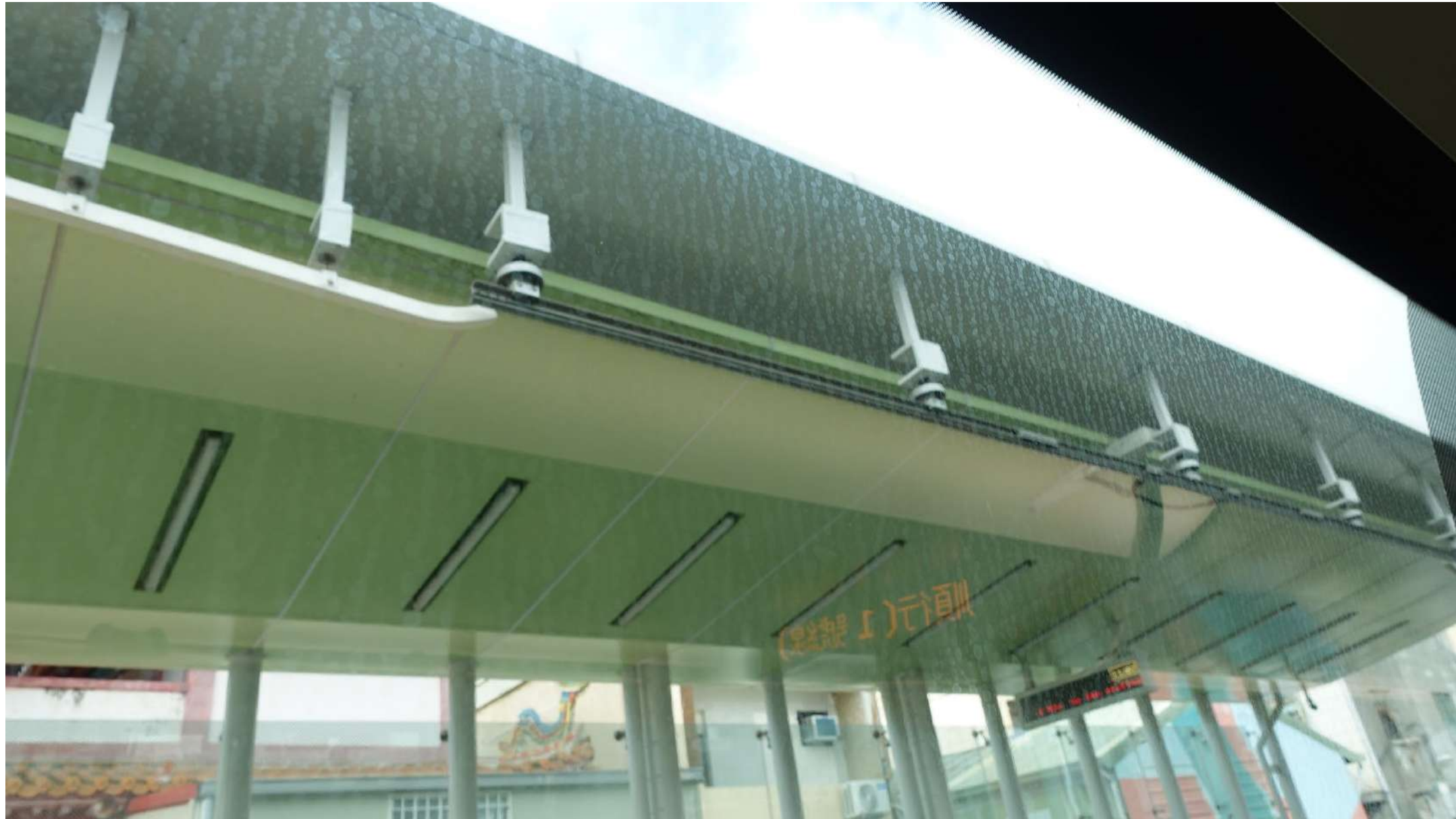
駅の充電用の架線。ここにキャパシタートラムからパンタグラフが出て来て接触して充電する。
