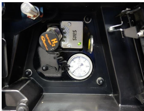
車両側面の水素充填口
