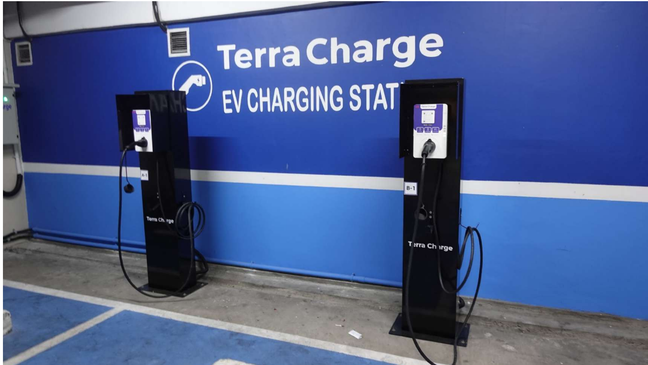
CCS2の充電器2基がショッピングセンターの駐車場に置かれていた。
