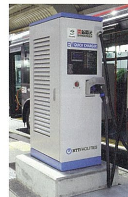
停留所に設置される急速充電器は、地元秋田県の企業である新電源工業(株)が製作したもので、寒冷地仕様になっている
